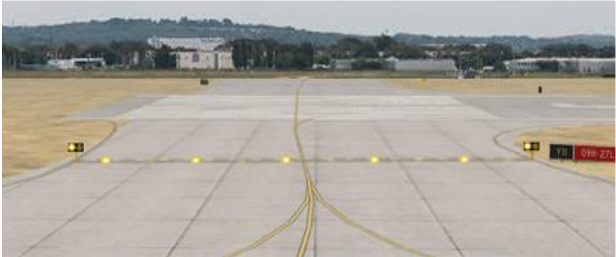
Figure 45- feux rouge en travers [Avionnaire]
