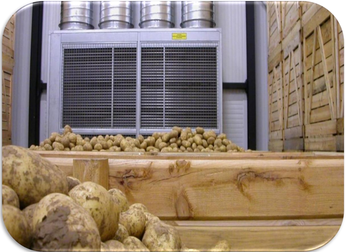
Figure09 : Stockage et conservation des pommes de terre dans un entrepôt équipé d'un système de ventilation et de refroidissement.
