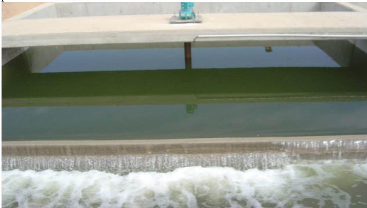
Figure III-09 : Sortie du bassin de floculation (Manuel de la station. 2006).
