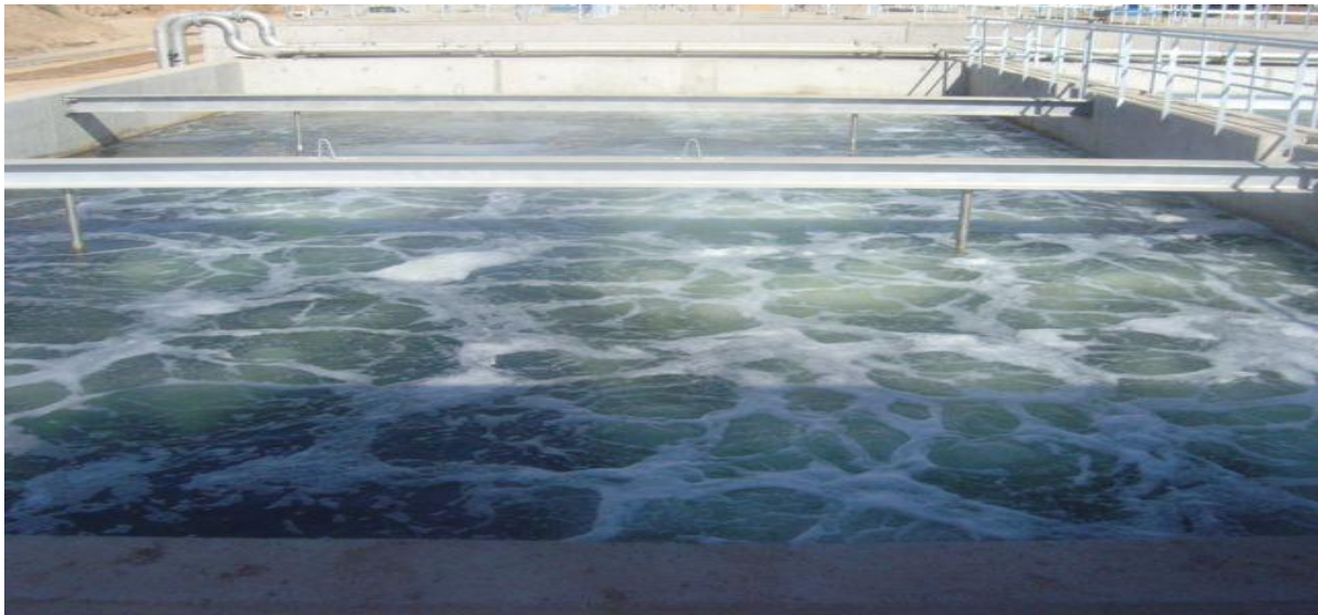
Figure III-11 : Bassin de nitrification (Manuel de la station. 2006).
