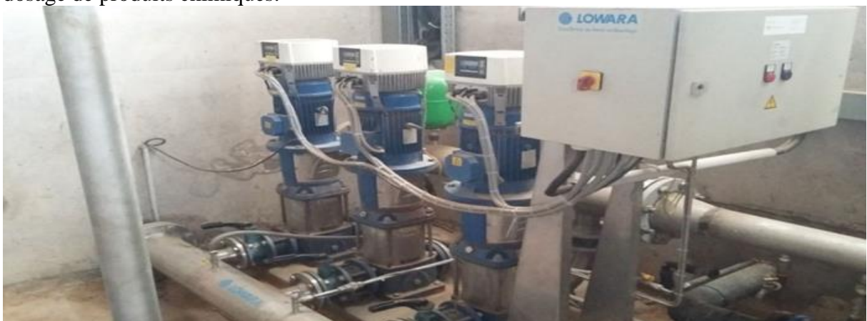
Figure III-15: Unité d'augmentation de pression d'eau de service.
