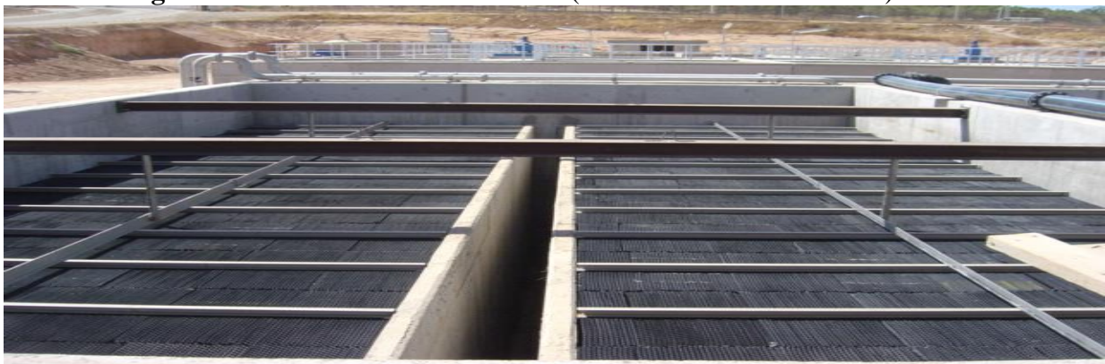
Figure III-12 : Bassin de nitrification vide (Manuel de la station. 2006).
