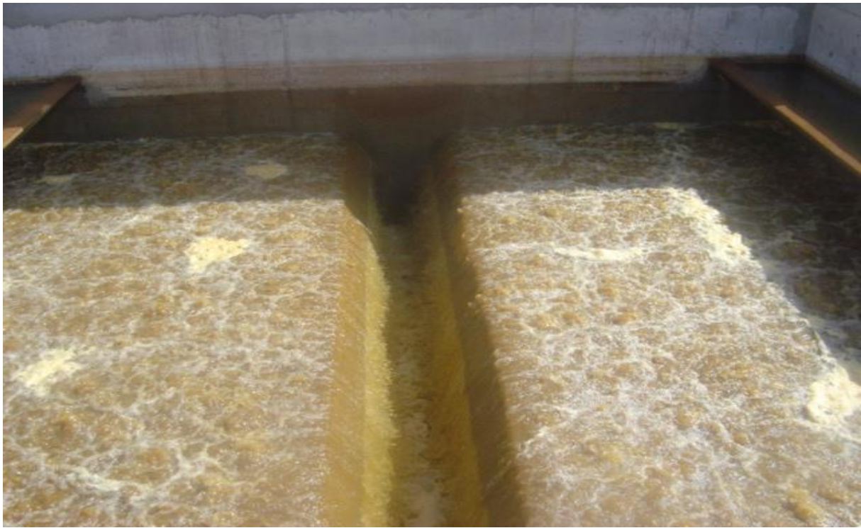
Figure III-14 : Filtre à sable pendant une phase de lavage à contre-courant.
