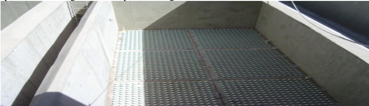
Figure III-14 : Filtre à sable avec les buses d'air vide (Manuel de la station. 2006).
