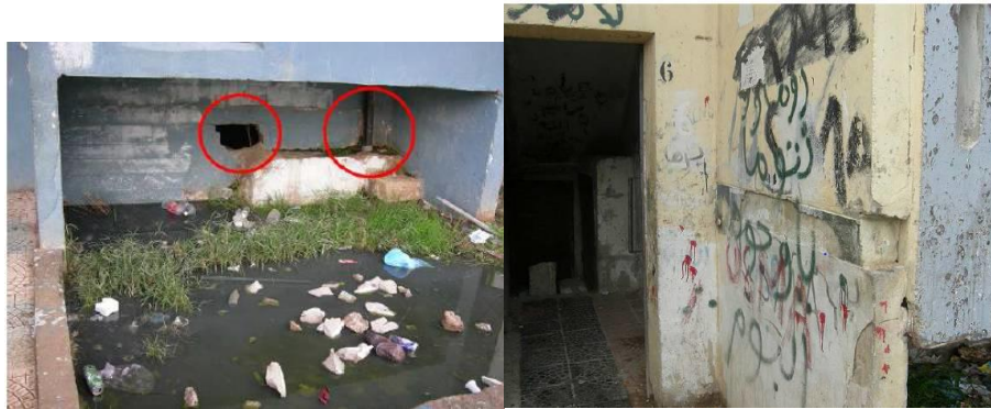
Figure122: montrent l'état d'avancement de dégradation au niveau de cadre bâti des cités collectives de la ville d'Annaba source : NAHAL, A, 2012.
