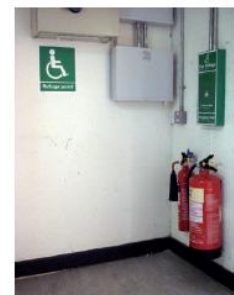
✓ Extincteur placé à bonne hauteur
