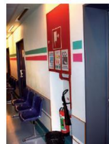
✓ Extincteur placé dans une niche
