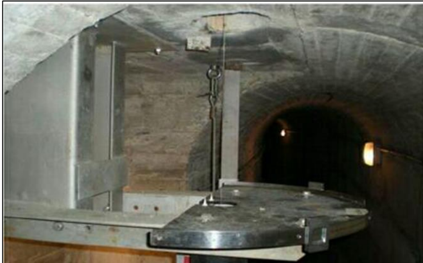
Photo 2 : Installation d'un pendule avec table de lecture dans une galerie de barrage (R.Nadia,2014).
