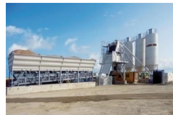
Figure 99. Centrale à béton.
