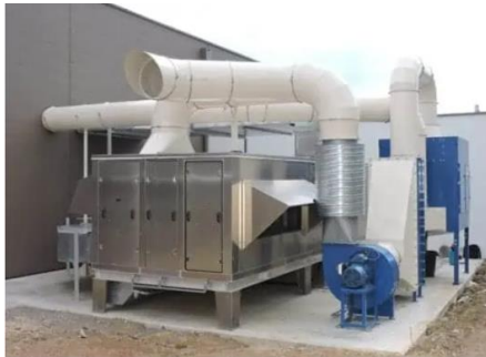
Figure 203. Centrale de traitement
