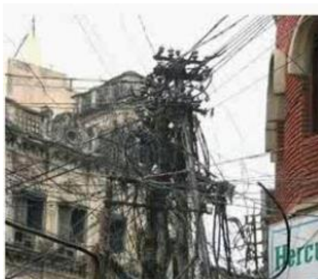
Figure 12: Problème de câble
