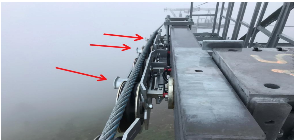
Figure 42 rattrape-câbles d'un balancier de galets sur un pylône support [30]
