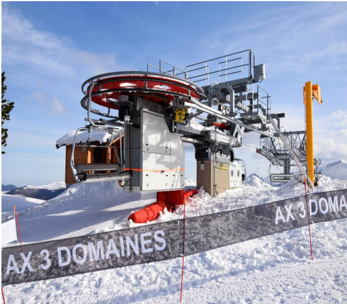
Figure 32 Station motrice de télésiège avec système de tension [30]
