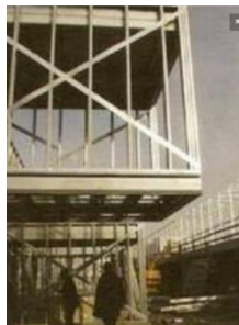
Figure 19 : Ossature légère avec un porte-à-faux nécessitant une reprise sur profilés standards. Cité Manifeste à Mulhouse D. Lewis, Scape architecture-Block
