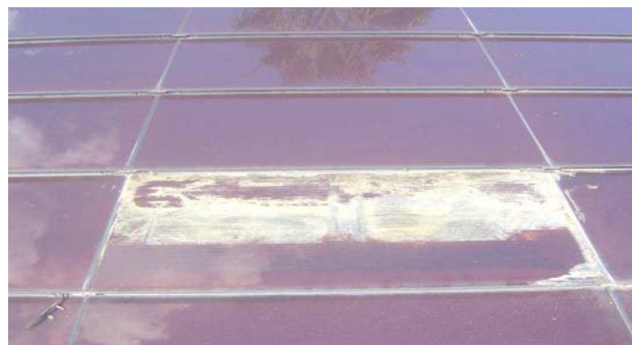
Figure (II-12). Dégradation des modules PV sur le site de l'ENEA-Portici
