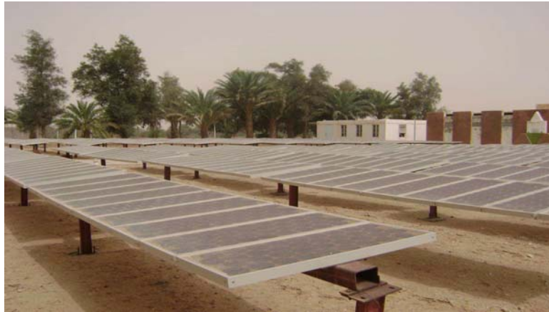
Figure (II-7) : Générateur de modules PV sur le site de MELOUKA
