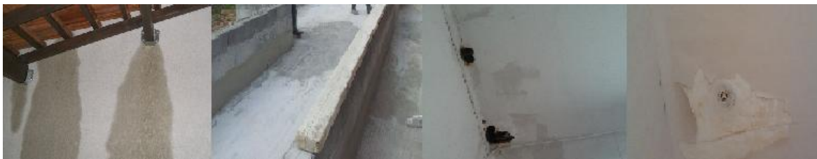
Figure III. 1 : Les problèmes d'étanchéités
