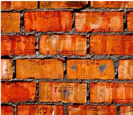
(a)- effritement de joint.
