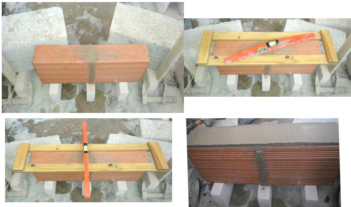
Figure 3.31 : Remplissage des joints verticaux ensuite l'étalement de la première couche du mortier.
