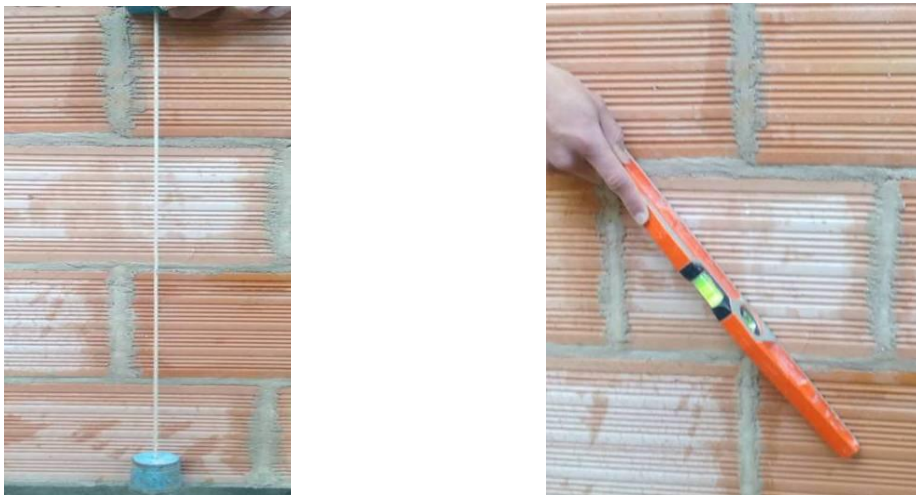
Figure 3.34 : Vérification de la planéité à l'aide d'un fil à plomb et du niveau à bulle.
