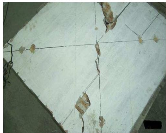
Figure 2.3 : Rupture généralisée de la paroi [GABOR et Coll. 2005].
