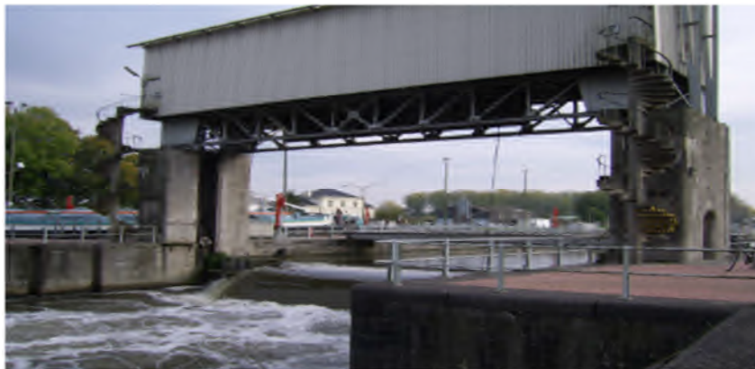
Photo II.2 : Vanne levante avec hausse (barrage de Kain) [14].
