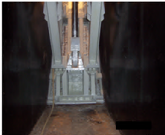
Photo III.3 : Vidange de fond barrage Sidi-Abdelli par vanne secteur.
