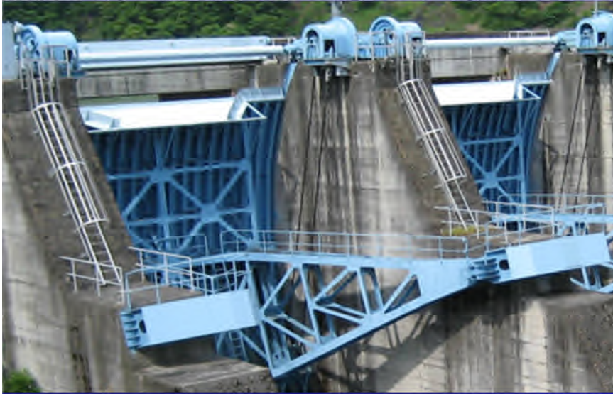
Photo I.10 : Vanne segment installée sur déversoir [8].
