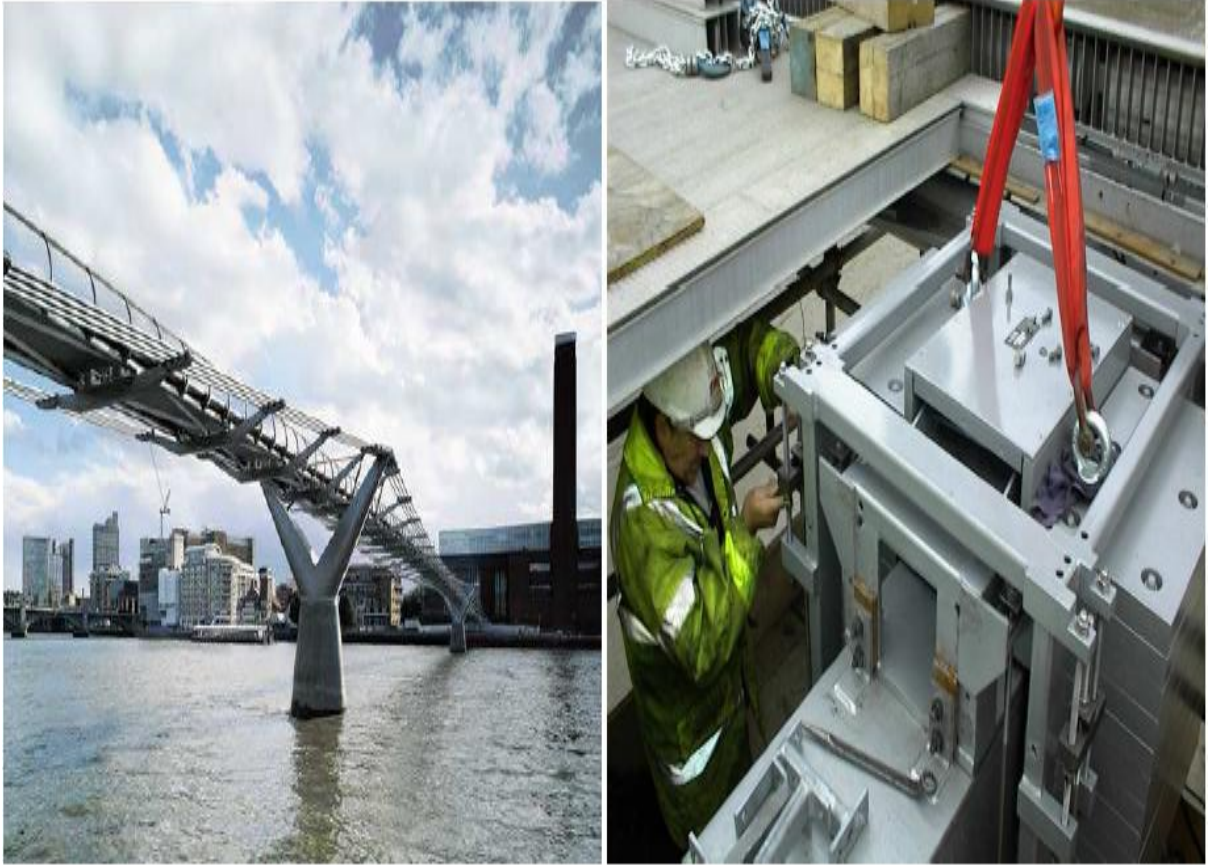
Figure 1.14 : Pont Millennium à Londres et l'installation d'un TMD (Nawrotzki, 2008).
