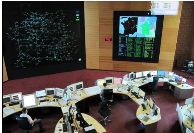
Figure 1.14 : Exemple d'un centre de dispatching en France
