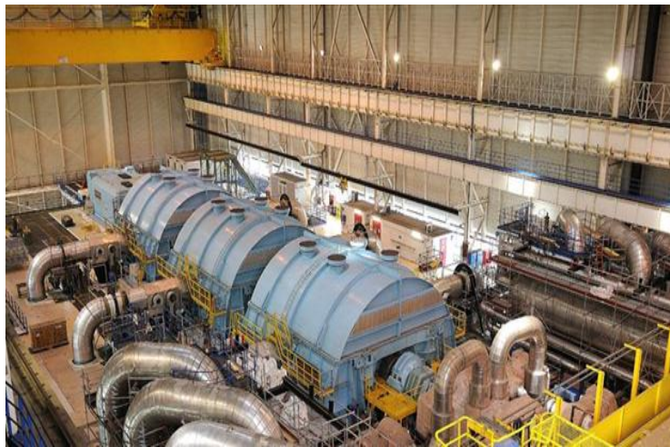
Figure1.9 : Alternateur d'une centrale électrique.
