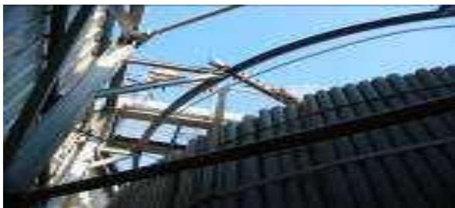
Figure II.4 : Photo de sprinkler de la Step API SOLLAC à Florange [67].
