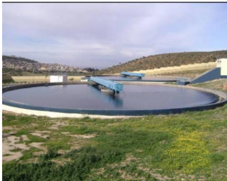
Figure II.6 : Un clarificateur (STEP de Ain Houtz).
