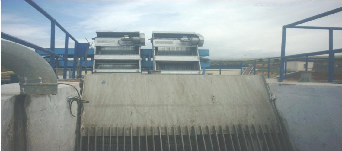
Photo II.4 : Grille grossière manuelle
