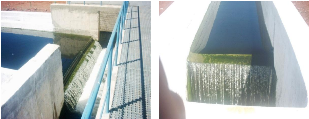
Photo II.13 : Bassin de chloration
