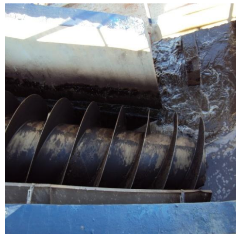
Photo II.10 : Vis de recirculation de l'eau nitrifiée vers la zone non aérée
