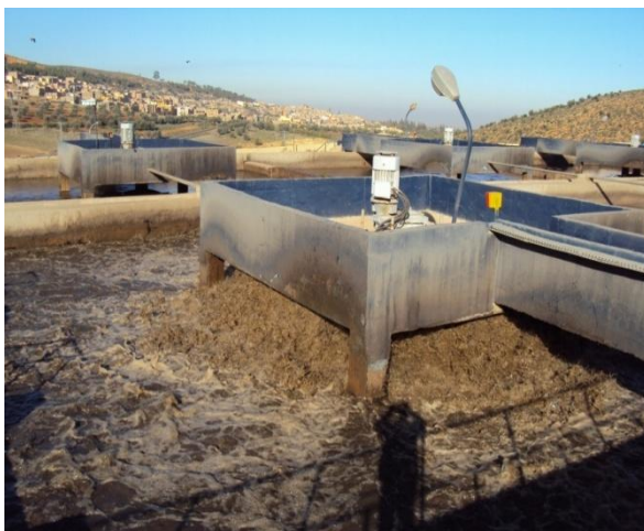
Photo II.9 : La zone aérée dans le Bassin d'aération
