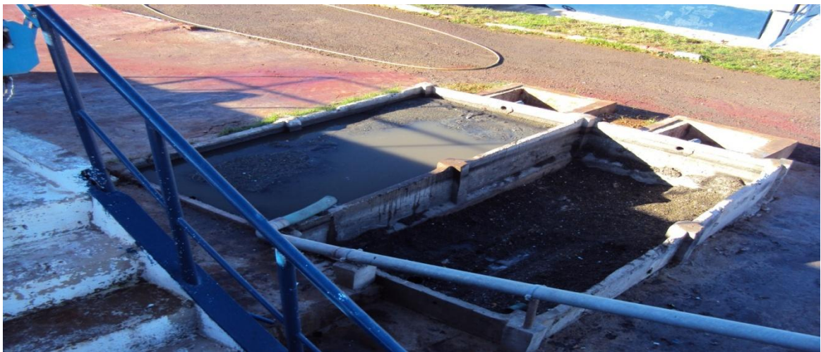
Photo II.7 : Bac de récupération des sables et graisses
