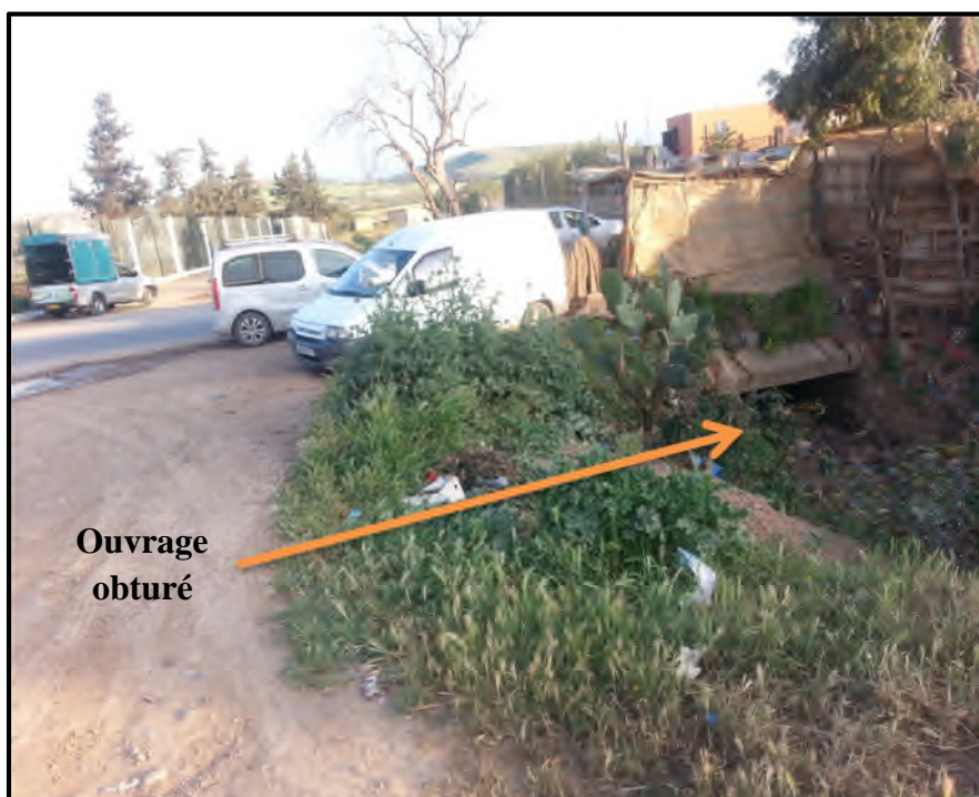
Photo III.5 : Ouvrage de traversée obturé
