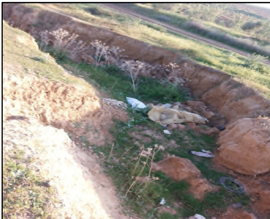
Photo III.4 : Tracé de l'oued nécessitant un recalibrage
