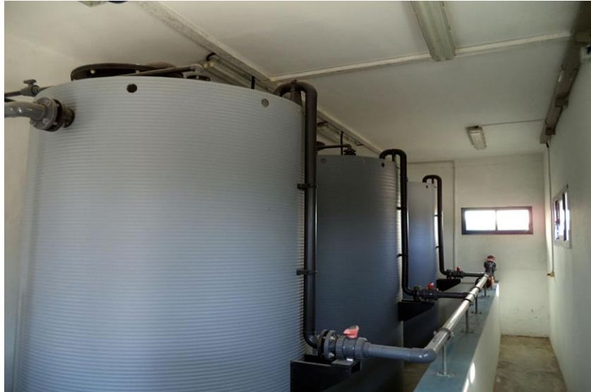
Figure III.12 : Photo de la station de dosage d'hypochlorite de sodium
