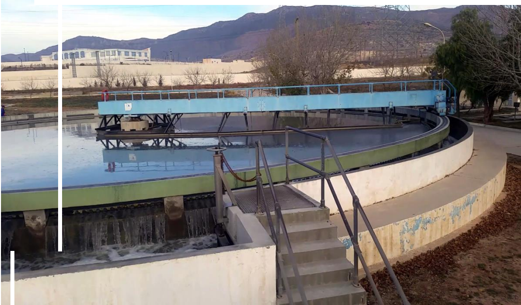
Figure III.08 : Photo du décanteurs primaire.
