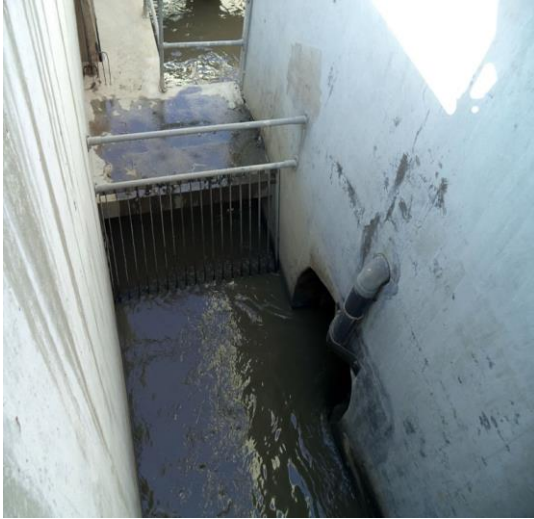
Figure III.03 : Photo Pré-dégrillage grossier
