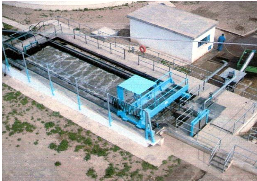
Figure III.06 : Photo du déssableur-déshuileur.
