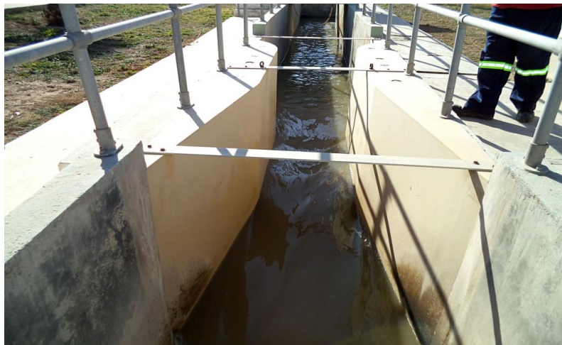
Figure III.11 : Canal de comptage et de mesure (eau épurée)
