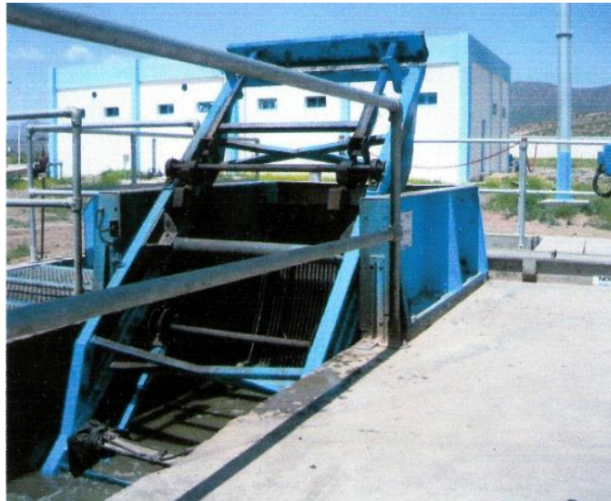
Figure III.05 : Photo du dégrilleur mécanique.
