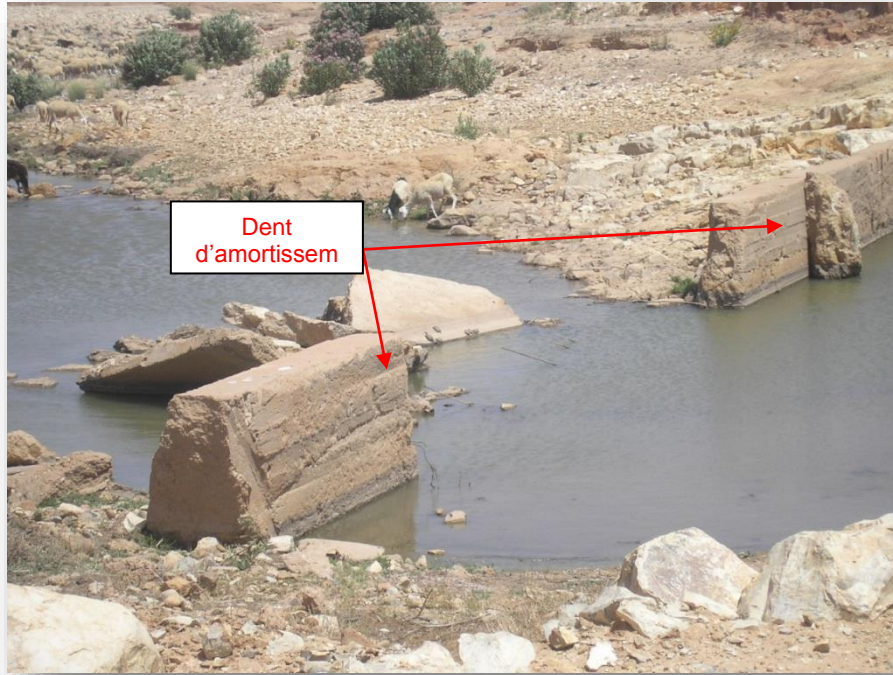
Photo 3.14 : dent d'amortissement du bassin emportée, absence de protection aval contre les affouillements (CTH, 2006)
