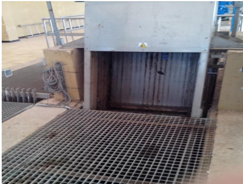
Figure III.3 : Grille mécanisée grossière
