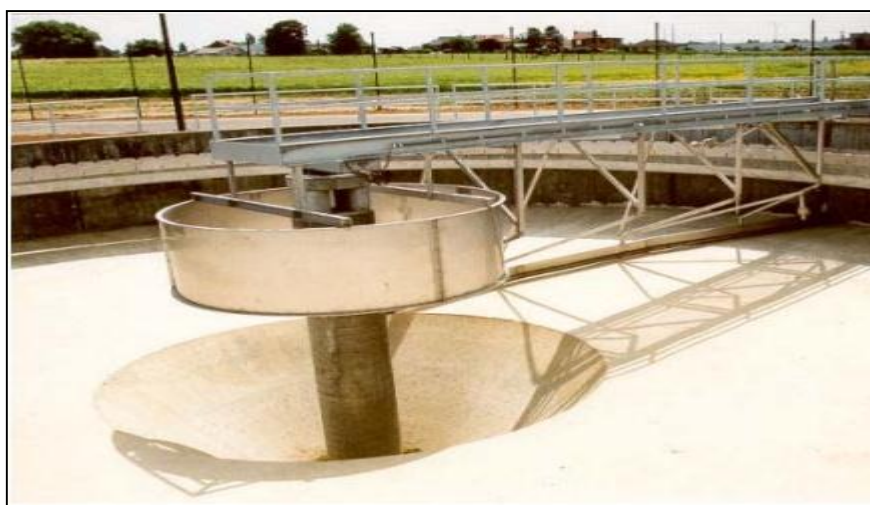
Figure II.6 : Décanteur primaire avec pont racleur à engrainement périphérique [34].
