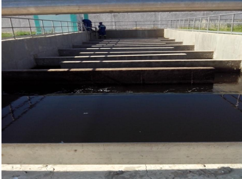
Figure III.13 : bassin de désinfection
