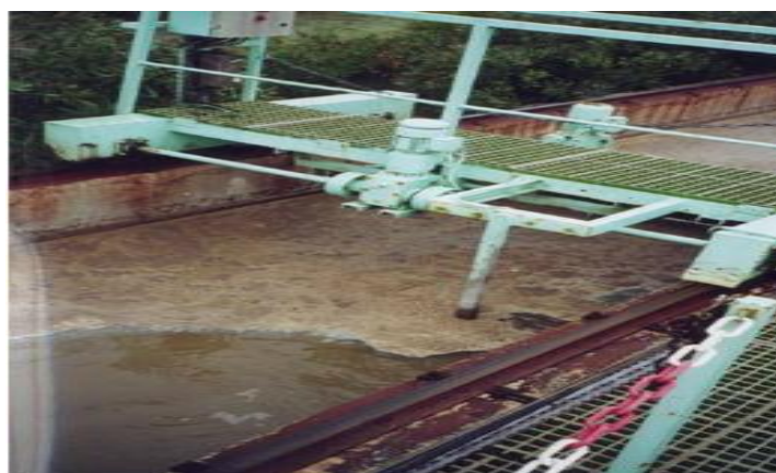
Figure II.5 : Photo d'un déshuileur utilisé dans l'épuration des eaux usées [a5].
