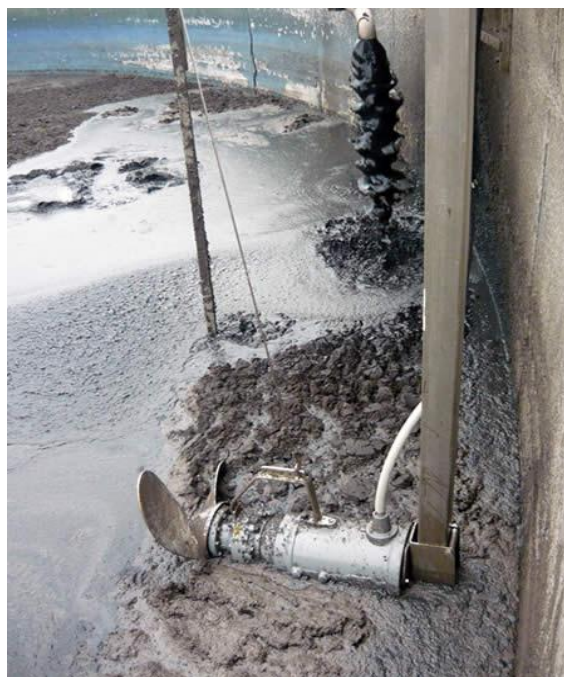
Figure IV.14 : Un mélangeur de fond (submersible)
