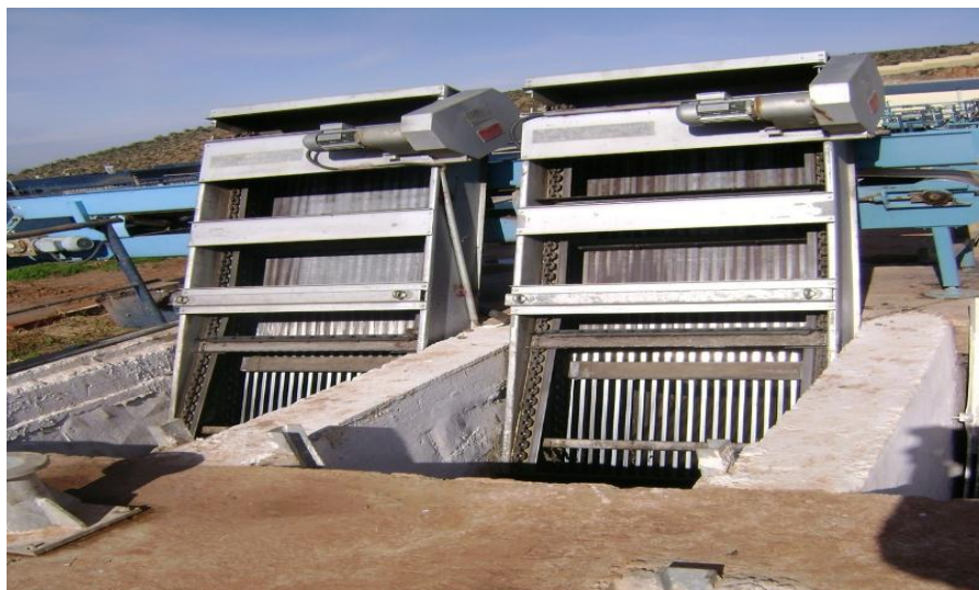
Figure III.4: Photo de la grille mécanisée (2 unités)
