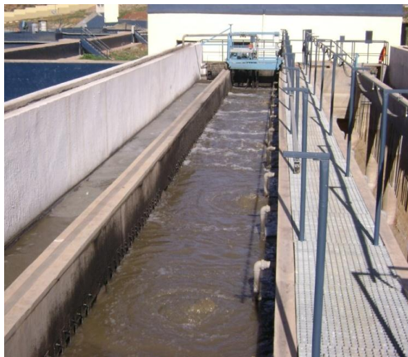
Figure III.6: Photo du dessableur- déshuileur .
