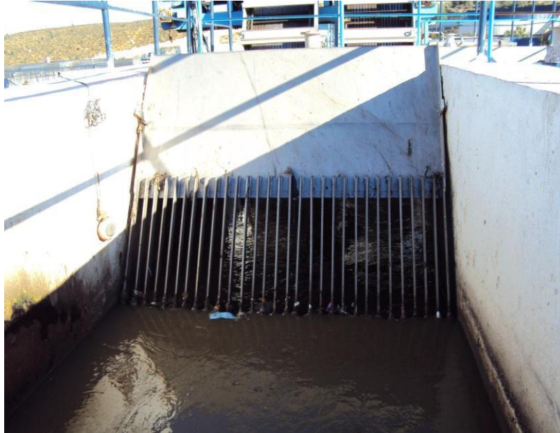
Figure III.3: Photo de la grille grossière manuelle (1 unité)
