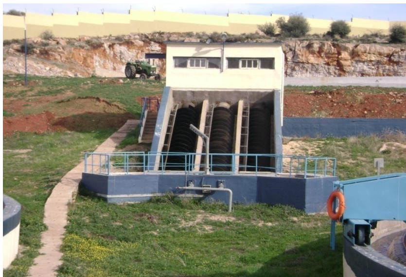
Figure III.12 : Photo des vis de recirculation des boues
