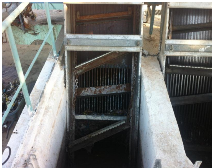
Figure IV.9: Photo du Degriilleur mécanique en panne
