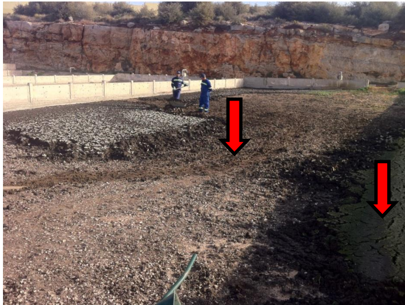
Figure IV.15 : Photo d'un lit de séchage endommagé
