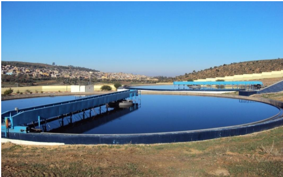
Figure III.10 : Photo du décanteur secondaire
