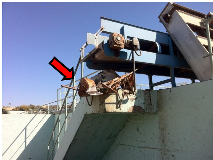
Figure IV.11. Photo de la table transporteuse des déchets
