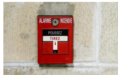
Figure 114 Alarme manuelle d'incendie
