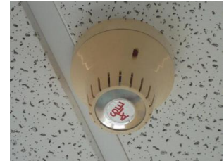
Figure 111 Détecteur de fumée
