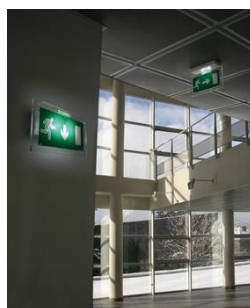
Figure 115 Eclairage de sécurité
