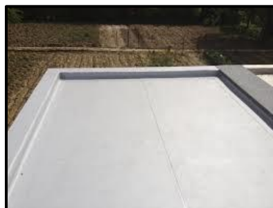
Figure 64 : étanchéité en pvc
