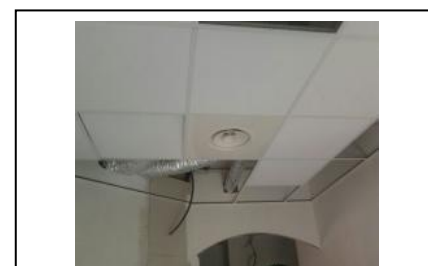
Figure 71: faux plafond en plaque hydrofuge
