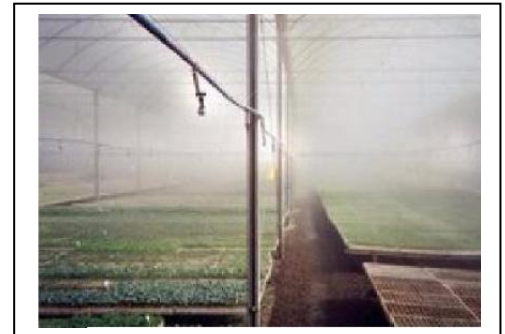
Figure92 : système de brumisation
