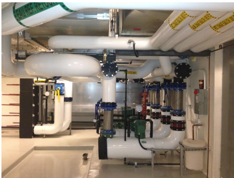
Figure 88. Salle de distribution des fluides médicaux 156
