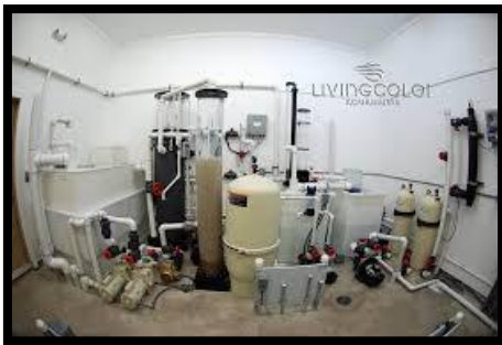
Figure 162 système de pompage
