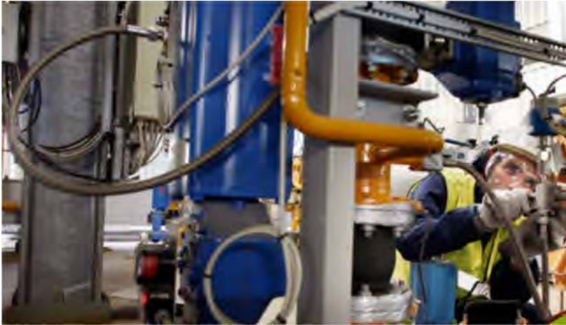
Usine de fabrication de pâte à papier
