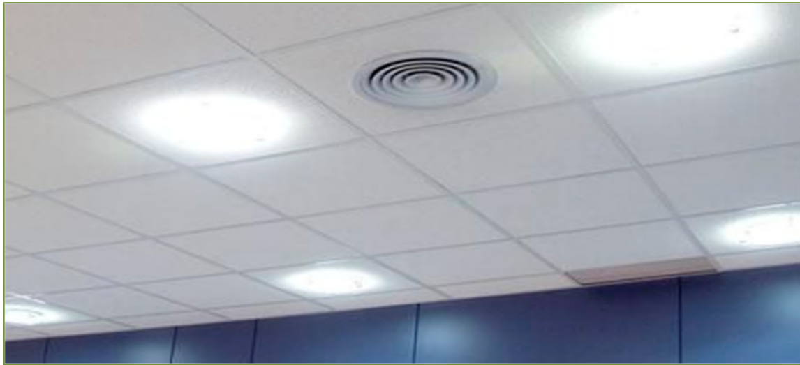
Fig. : climatisation faux plafond
