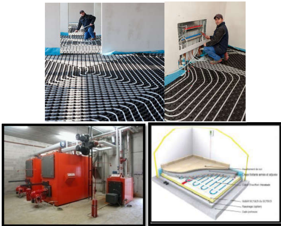
Photo 34 : Système de chauffage par le sol.
