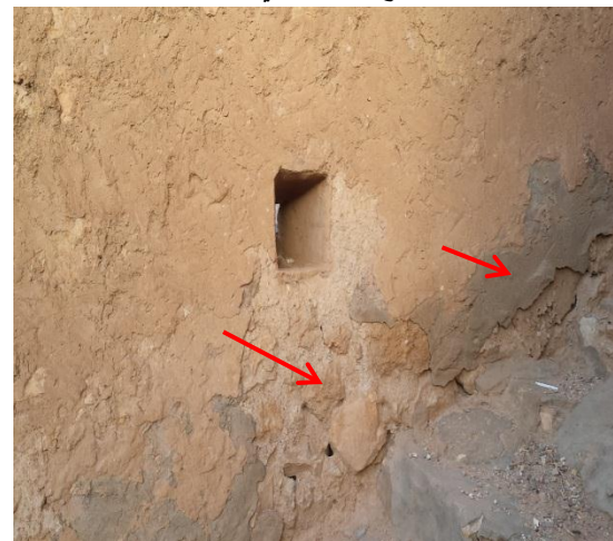
الصورة 124: تفتت الملاط وإجراء عملية الترميم بمادة الإسمنت لسور مدينة بني يزقن.
