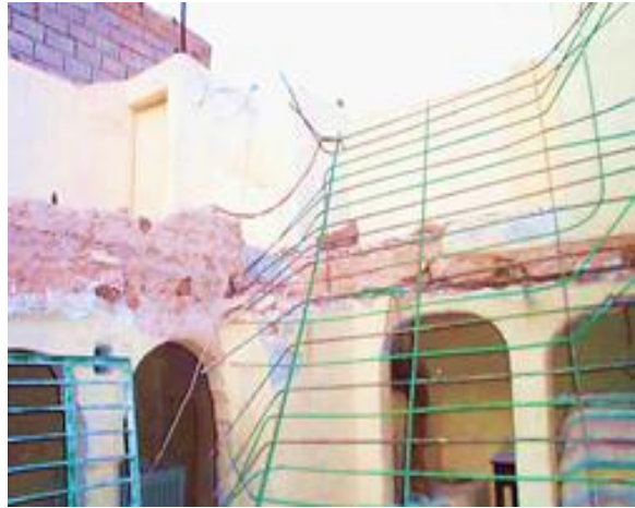
الصورة 98: تغيير شبك الطابق الأول خلال عملية الترميم بمسكن في مدينة غرداية.
