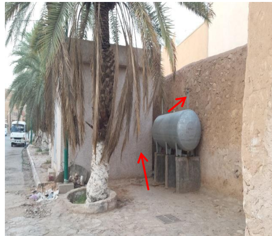
الصورة 118: خزانات المياه التي خرقت السور والمحولات الكهربائية التي شوهت سور مدينة بني يزقن.
