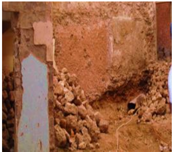
الصورة 64: المساكن المنهارة داخل مدينة غرداية.
