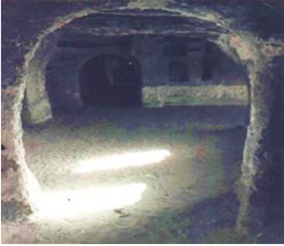
الصورة 43: مجال مخصص للتعليم في مصلى عمي سعيد بمدينة غرداية سنة 2000م قبل عملية الترميم عن OPVM.
