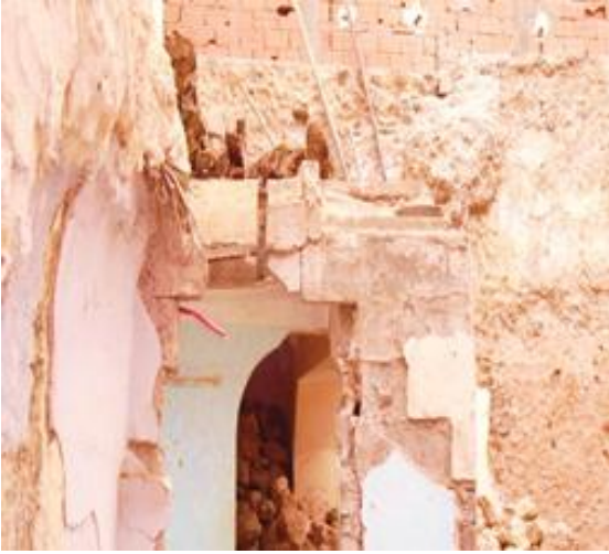
الصورة 63: المساكن المنهارة داخل مدينة غرداية.
