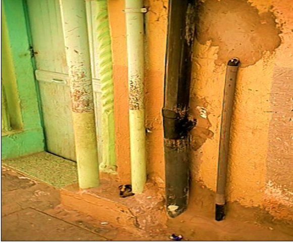
الصورة 85: التشوه البصري جراء شبكات الصرف الصحي بمدينة غرداية.
