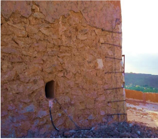
الصورة 39: عمليات الترميم الخاطئة بمنذنة مسجد قصر بنورة القديم.
