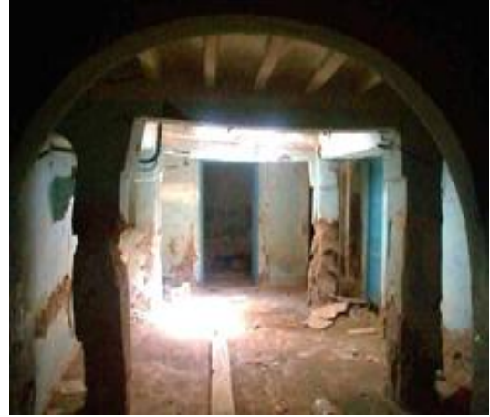
الصورة 92: قبل عملية الترميم لأعمدة صحن المسكن وأرضيته في مدينة غرداية.
