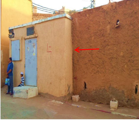
الصورة 121: المحولات الكهربائية التي أخذت موقعا لها في سور بني يزقن.
