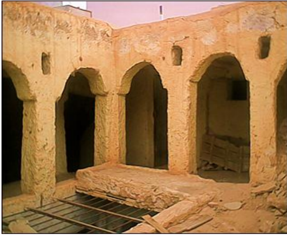
الصورة 81: تدهور السقف وتفتت الملاط في مسكن بمدينة غرداية عن مكتب الدراسات URBAT.
