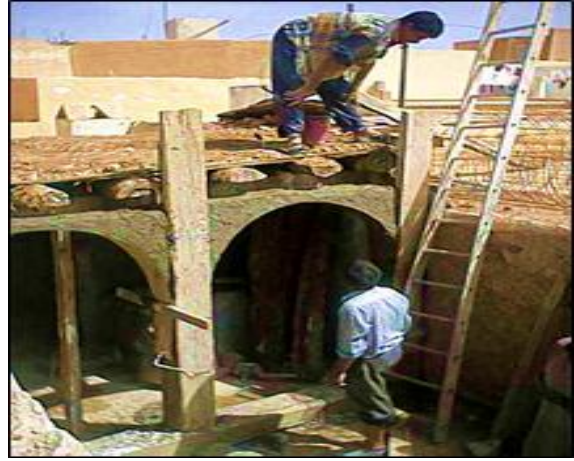
الصورة 96: أثناء عملية إعادة بناء الإيكومار في مسكن بمدينة غرداية عن OPVM.
