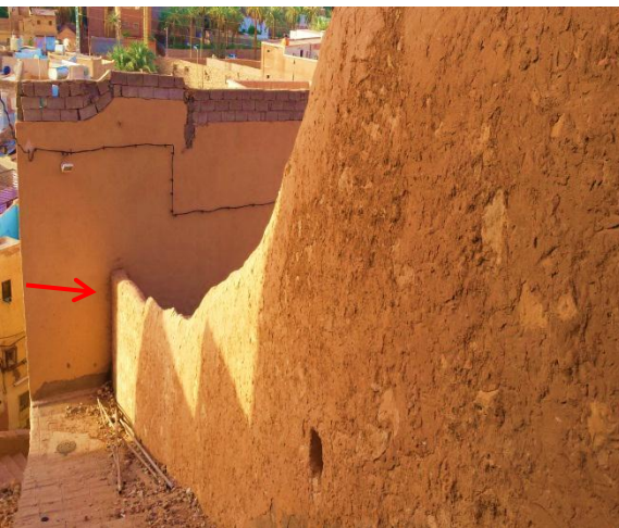
الصورة 125: خرق السور من إحدى بنايات الخواص في مدينة بني يزقن.
