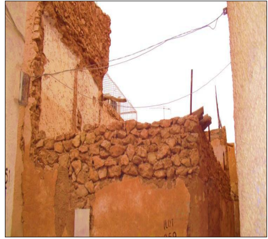
الصورة 56: المساكن المتدهورة داخل مدينة غرداية.
