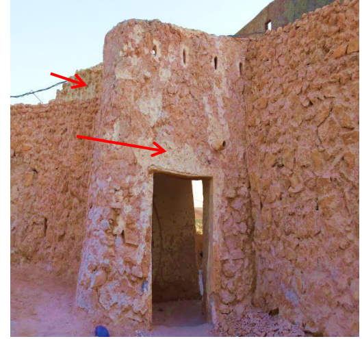
الصورة 122: الترميمات الخاطئة في الباب الفرعي الشيخ بلحاج بمدينة بني يزقن.
