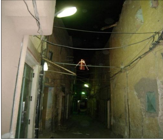
الصورة 87: توصيلات الكهرباء المتداخلة بمدينة غرداية.
