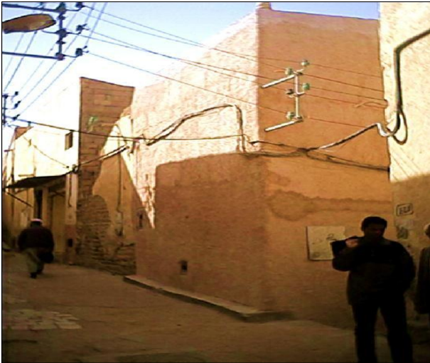
الصورة 89: توصيلات الكهرباء المتداخلة بمدينة غرداية.
