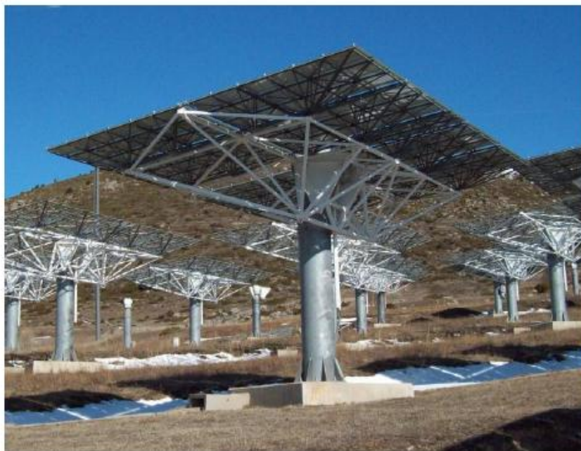
Figure II.6 : Héliostat de la centrale THEMIS.
