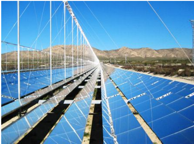
(a) Champ de miroirs construit par Novatec Biosol (Source : CNIM)
