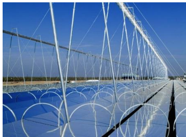
(d) Miroir de Fresnel - Centrale d'Areva (ex Ausra) à Bakersfield en Californie
