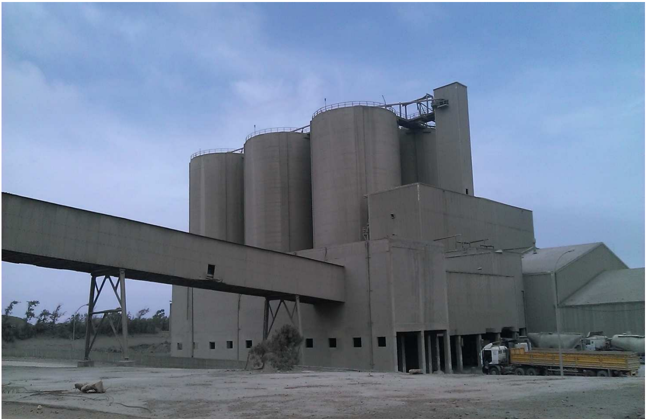
Figure I-13 : Silos de stockage de ciment.
