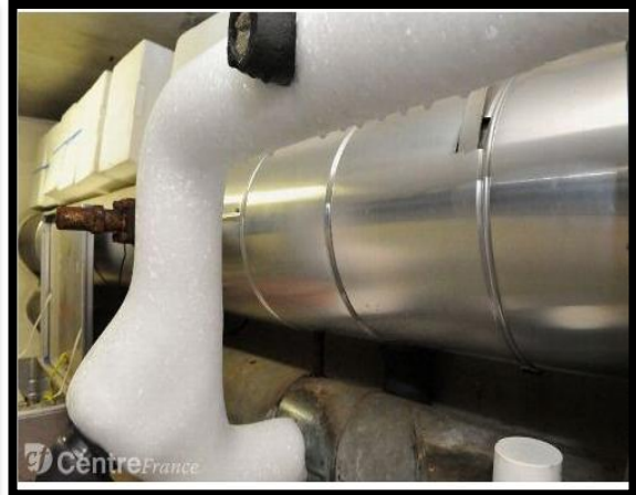
Figure 83 : un tuyau de compresseur de production de neige
