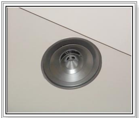
Figure 80 : bouche de soufflage
