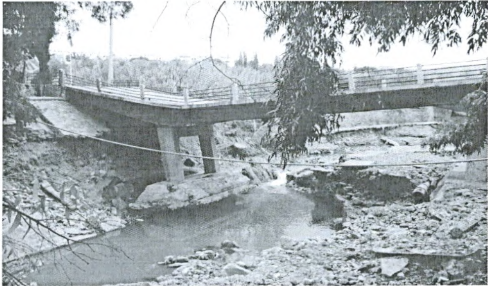
Figure I.11 : dégât causer par l'érosion sur les route (pont du quartier commando Mejdoub wilaya de .Saida, 2013)
