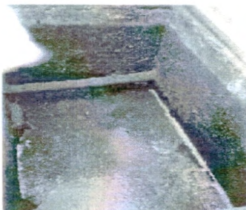
Fig n°9 : Bassin de décantation
