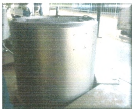
Cuve de collecte
