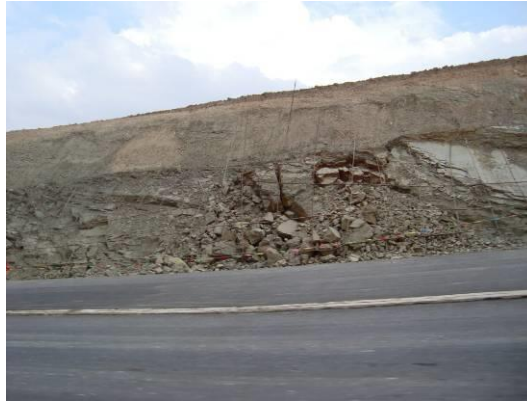
Photo I-1 : Eboulement d'un Talus au PK 121+100(Autoroute Est-Ouest 2010)
