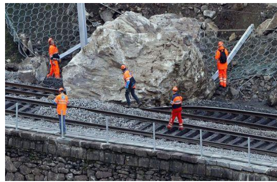
Photo I-3: Chutes de pierres et de blocs(Gothard 2012)
