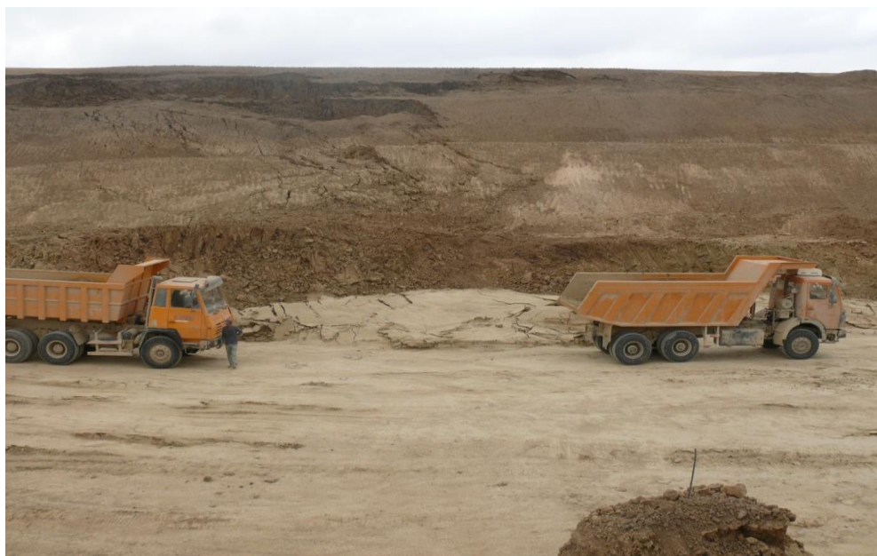
(Photo 3.3) Le glissement au tracer autoroutier lors des travaux au PK 47+700 ~ PK47+760
