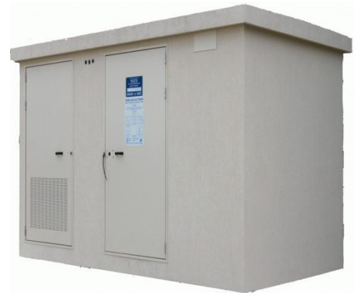
Poste de transformation électrique
