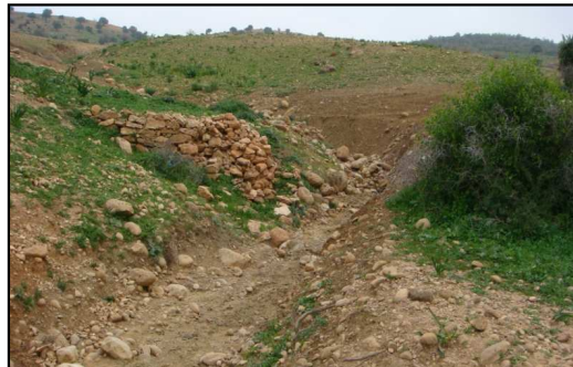
Photo n° 31 Seuil en pierre sèche emporté par les eaux
