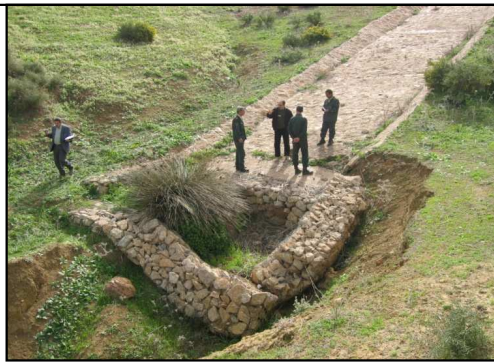
Photo n°27 Bassin de décantation d'un seuil en terre détruit par les mouvements du sol
