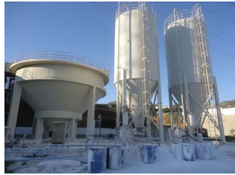
Figure 17: Système de dosage de la Chaux
