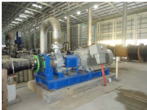
Figure 13 : Pompe à haute pression.
