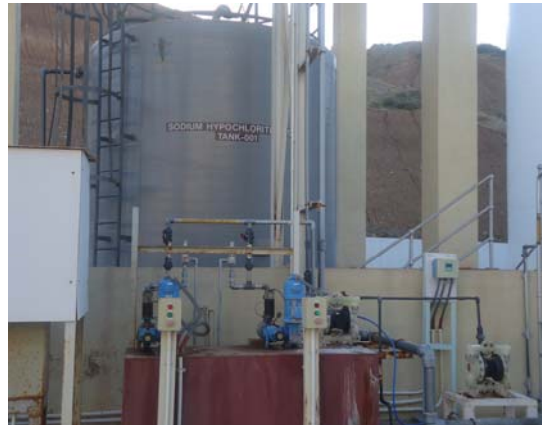
Figure 15 : Réservoir d'hypochlorite de sodium utilisé pour la désinfection finale.
