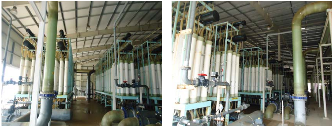
Figure 12 : Les modules d'ultrafiltration.
