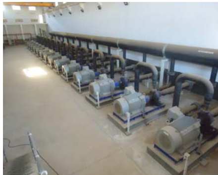
Figure 18: Station de pompage de l'eau traitée.
