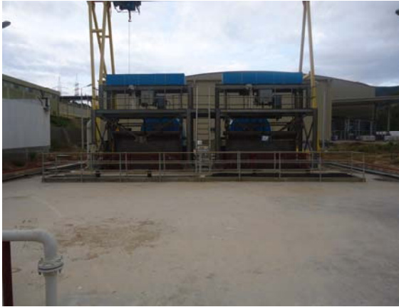
Figure 10: Le gros dégrilleur.
