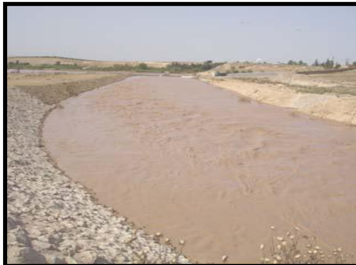
Photo II.3 : Canal de dérivation au Sud de la ville de Sidi Bel Abbés (HALLOUCHE – 2007)
