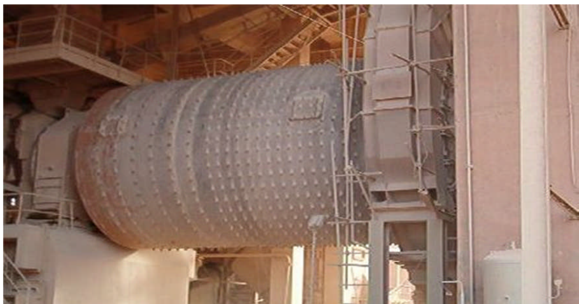
Figure 1.10 : Le broyage cru de la cimenterie de Béni-Saf.
