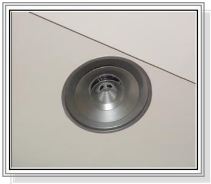
Bouches de Soufflage
