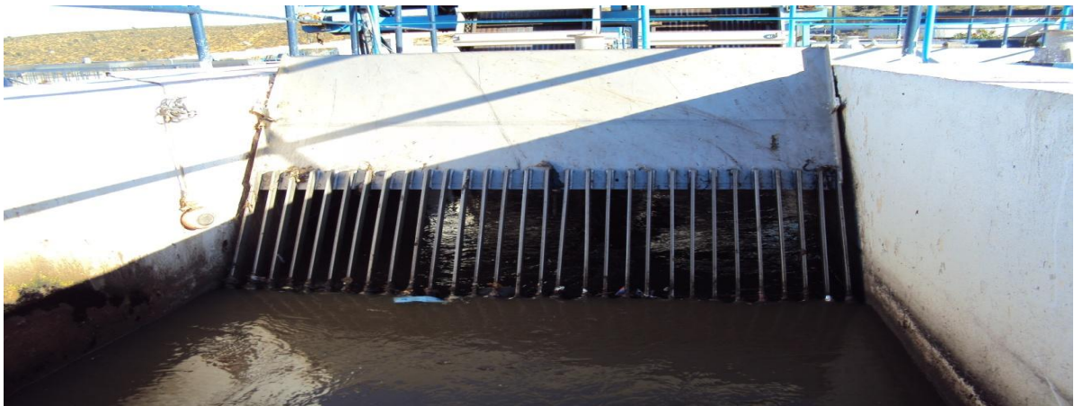
Figure II.3 Grille grossière manuelle (1unité) [2]
