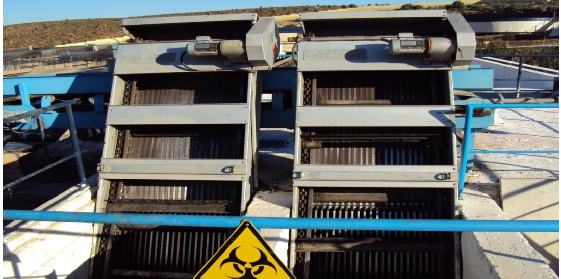
Figure II.4 Grille mécanisée (2 unités) [2]
