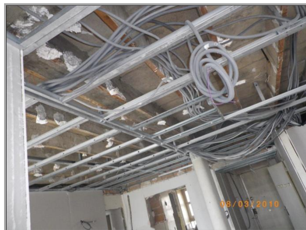
Figure 71: Le passage des câbles et gaines techniques.
