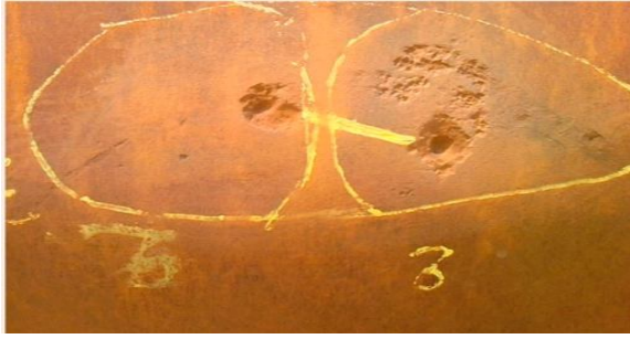
g. Pics de corrosion (localisée)
