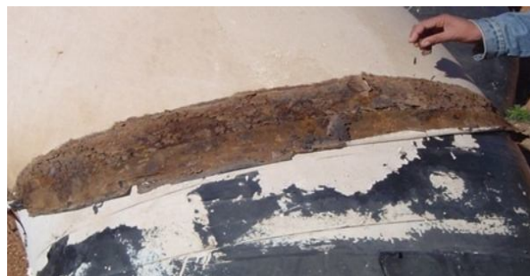
f. Défèrent type de corrosion
