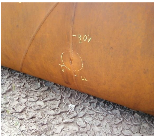
Figure 2.6.a : corrosion par piqure
