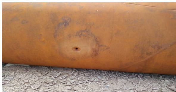
a. Corrosion externe par pique
