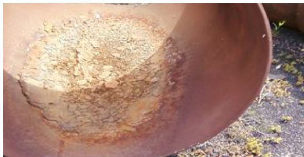
c. corrosion biologique
