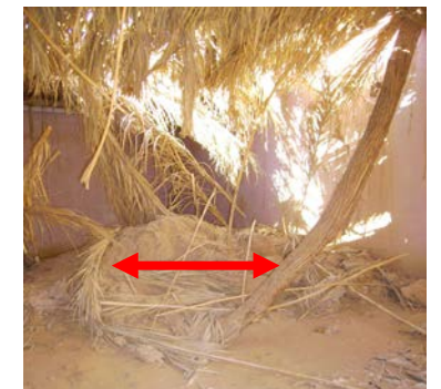
ص(142) انهيار بعض الأسقف بقصر الواعة
