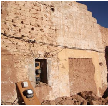
ص(153)أخطار سقوط أسلاك الكهرباء على الأرضيات
