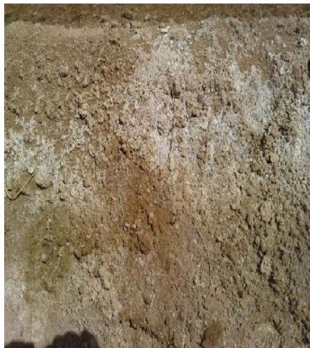
Photo n° 4: photo montre la présence des sels au sol
